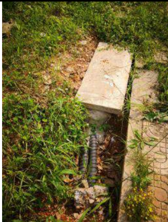
隔油池后处理池
