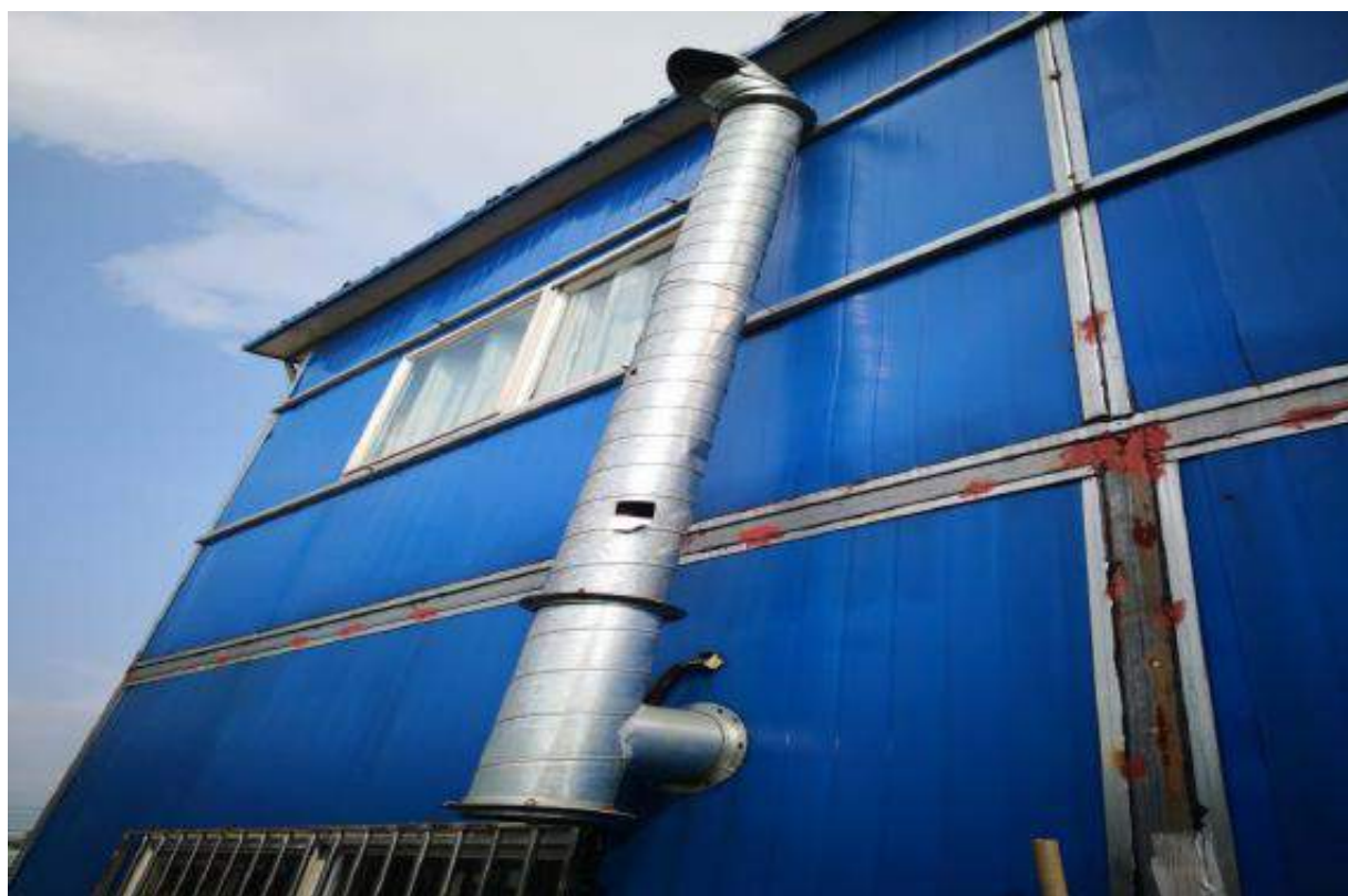
油烟净化器排气筒
