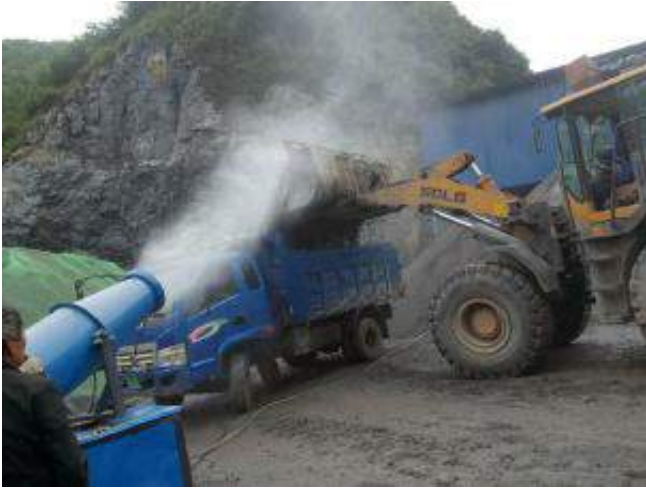
装载区喷雾除尘
